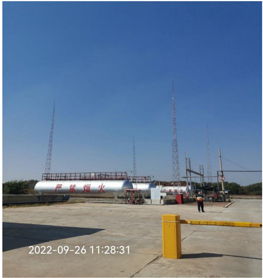
现场主要装置
